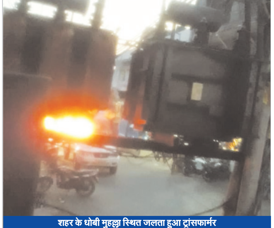
शहर के धोबी नुहल्ला स्थित जलता हुआ ट्रांसफार्मर
